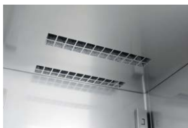
Dettaglio della ventilazione interna
